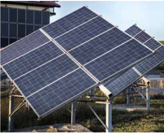
Imagen 4. Planta solar fotovoltaica de mediano porte
