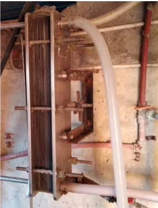
Imagen 2. Intercambiador de calor de placas
