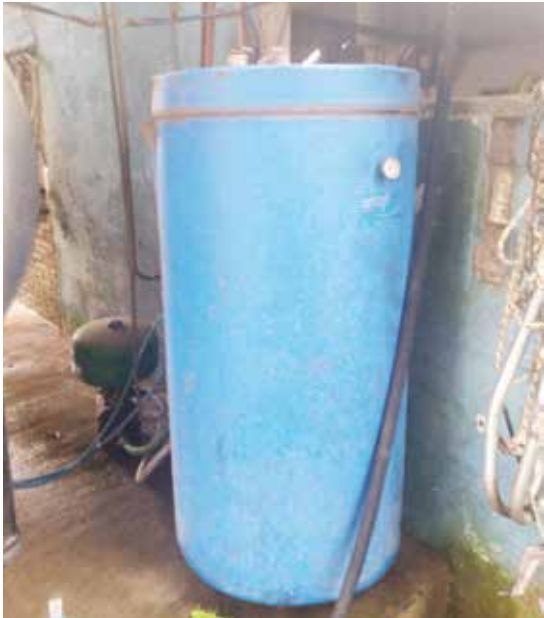
Imagen 3. Tanque recuperador de calor en funcionamiento
